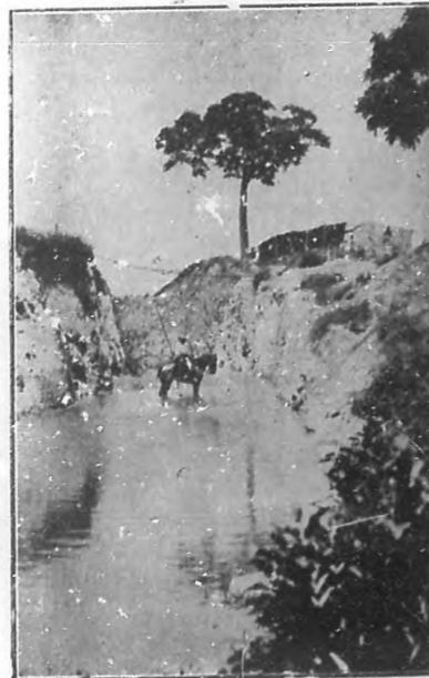
Excavación en el ferrocarril de Cumanayagua a Mina "Carlota" de los tranvías eléctricos, una de las más importantes obras realizadas por el Sr. Juan Garriga.
