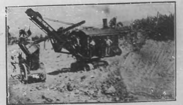
Paleadora en momentos de descargar, en las obras de construcción del señor Juan Garriga.
